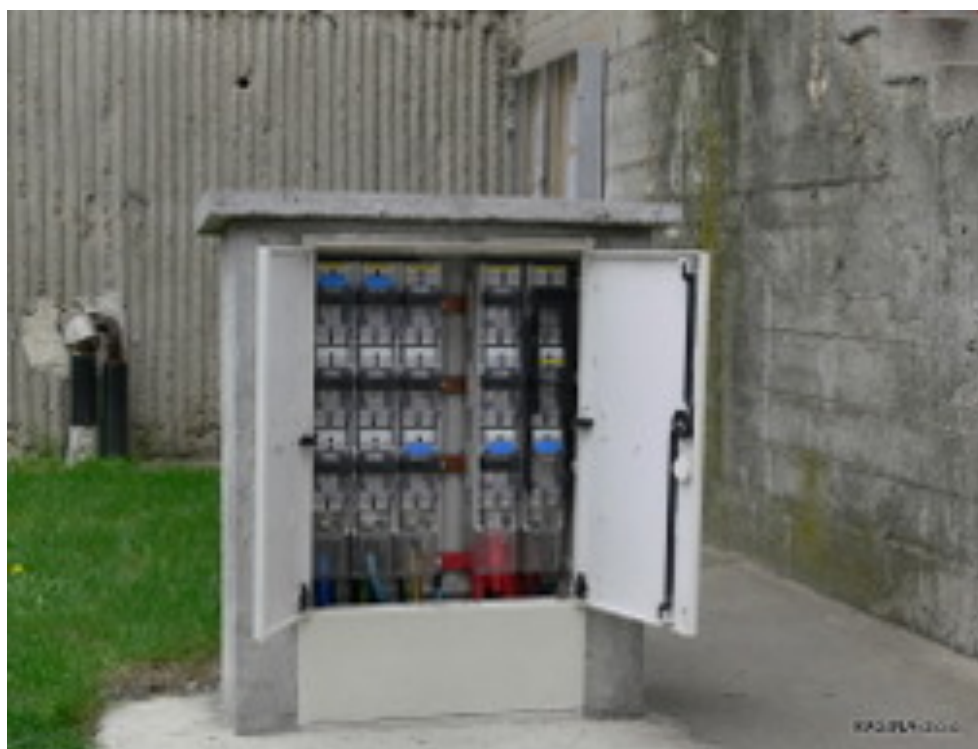
Sl. Izgled niskonaponskog razvodnog ormara sa 6 izvoda »NKRO6«
